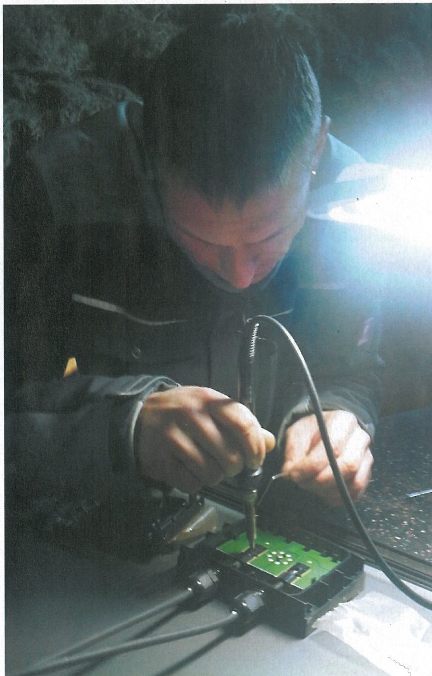
Die Reparatur von Scheuten-Modulen begann Anfang November in Südtirol. Ein Team von Suncycle besteht aus zwei Leuten – einer lötet den Kontakt in der Anschlussdose nach, der andere prüft die Temperatur des Lots.
